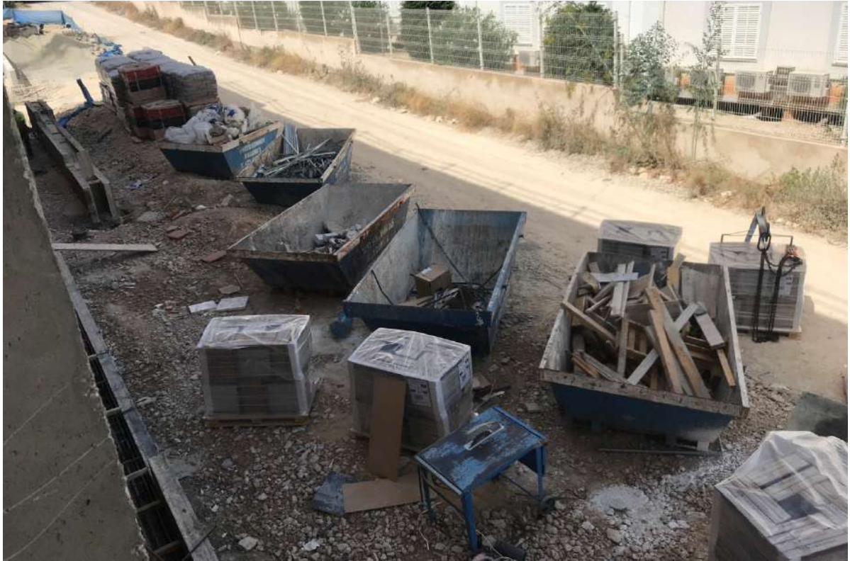
Vista de los contenedores metálicos presentes en la Fase 2 de la RES-4 de Santa Ponça destinados al acopio controlado de maderas, cartones, restos de hormigones y bloques, metales y plásticos.
