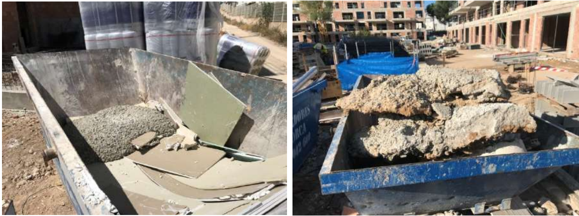
Restos de hormigón vertidos y depositados sobre sendos contenedores metálicos localizados en la Fase 2 y Fase 1 respectivamente.
