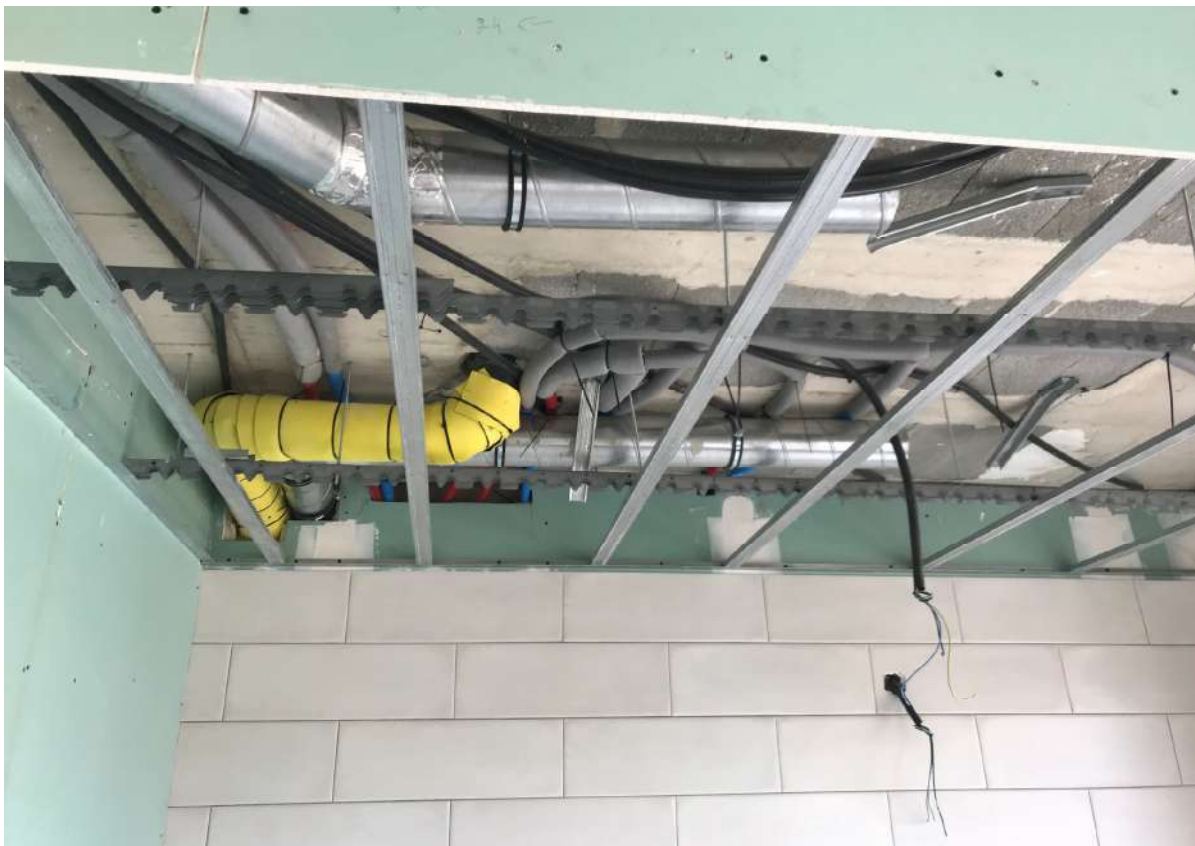
La imagen nos muestra el techo de una de las cocinas de la promoción en la cual se aprecia el tendido de los distintos servicios y conducciones que quedarán ocultos mediante lamas.
