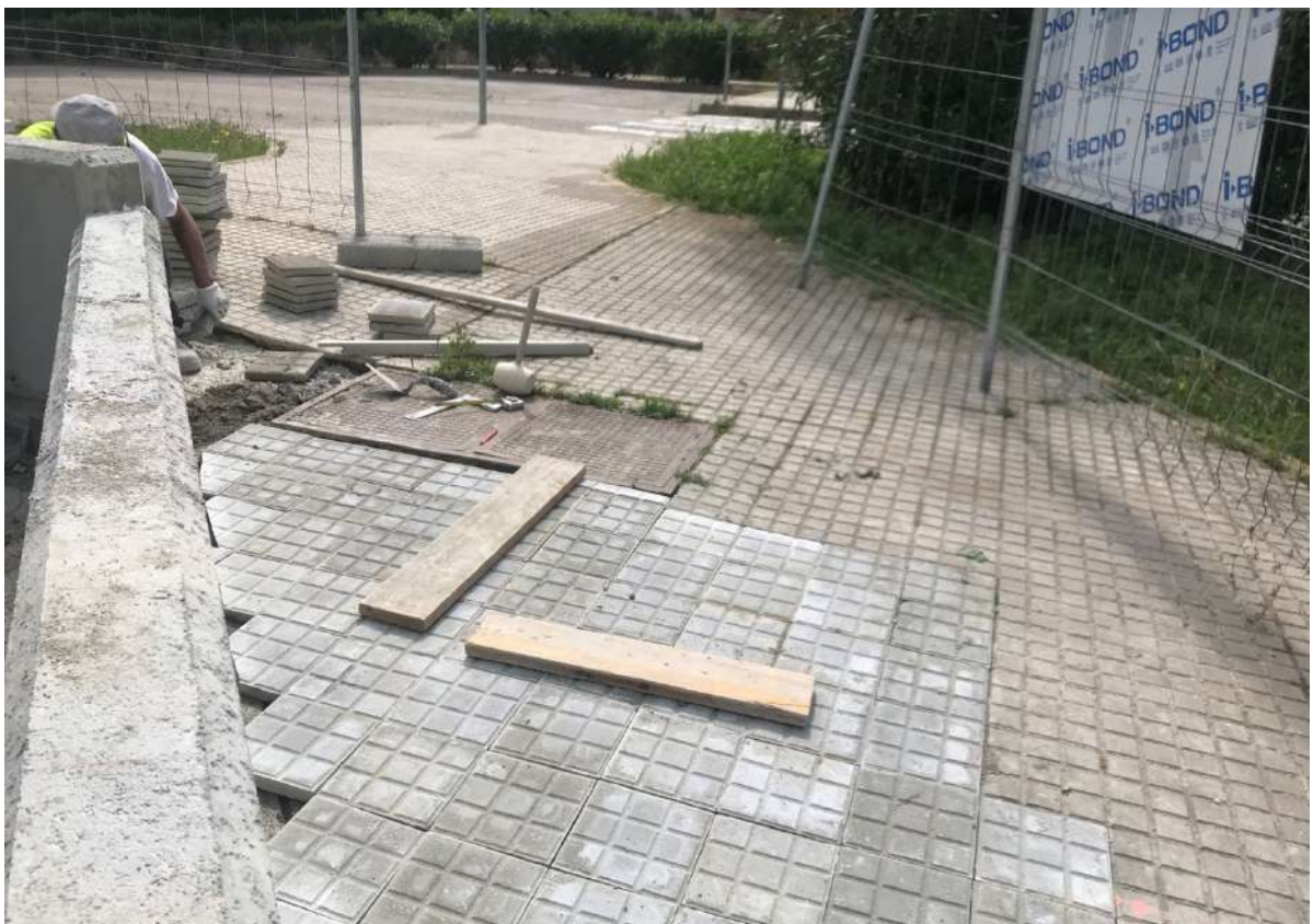
Detalle de uno de los operarios colocando las piezas de panot en el tramo de acera correspondiente al chafalán del solar que define la intersección Gran Vía des Salobrar con Avda. Club de Golf.
