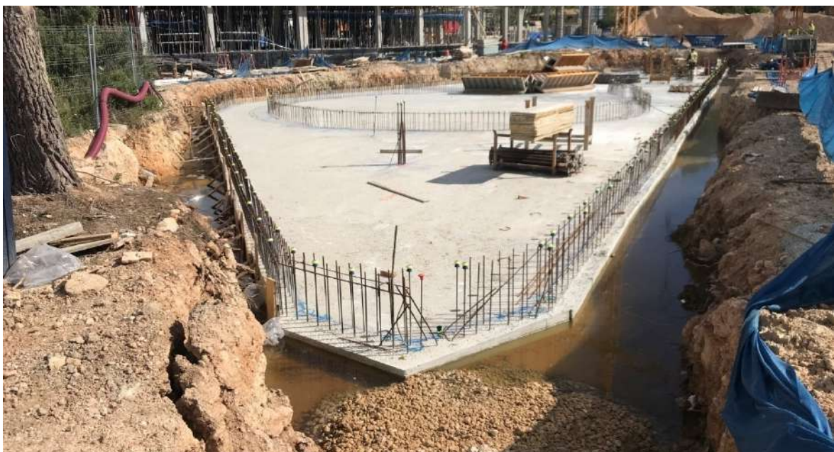
El agua que rodea la plataforma estructural que albergará la futura piscina corresponde al nivel freático del terreno.
