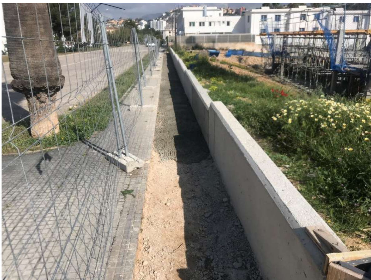
Cerramiento de la parcela a base de módulos de hormigón armado y detalle del tramo de acera colindante al muro sin embaldosar. El vial corresponde a la Avda. Club de Golf (oeste de la Fase 2).
