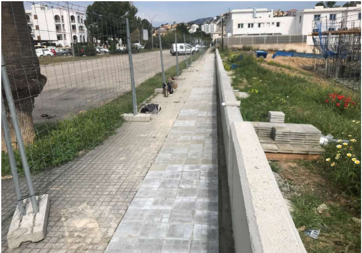
Misma imagen anterior en la que se aprecia la colocación de las piezas de panot hasta completar la acera en las inmediaciones del muro de cierre perimetral.
