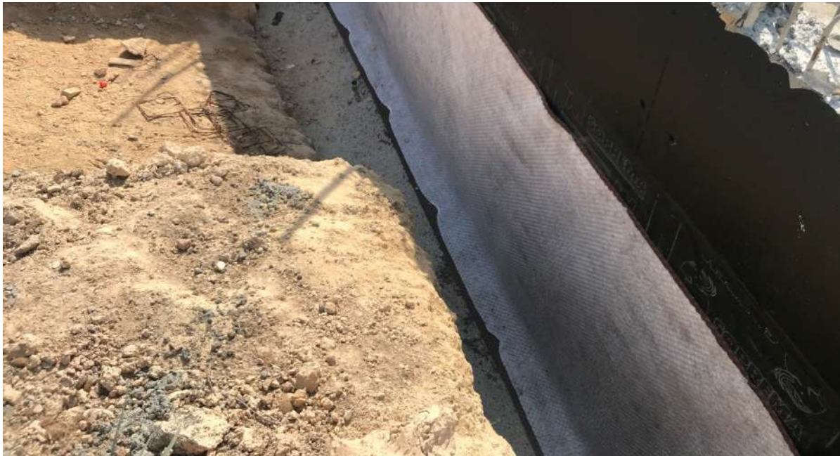
Capa de geotextil protegiendo el forjado sanitario de una de las edificaciones de la urbanización.
